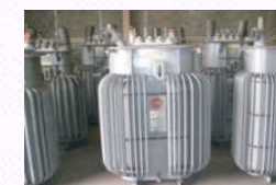
PCBが含まれる 高圧トランス
