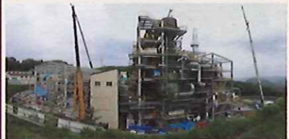
飯館村小宮地区における仮設焼却炉の建設状況(平成26年6月)
