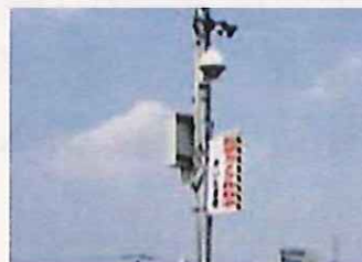
【市内に設置した監視カメラ】
