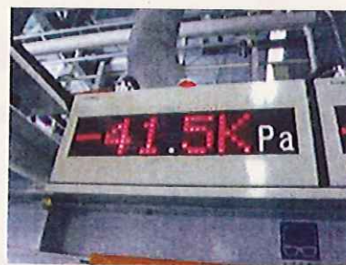
冷凍回路内の圧力表示
