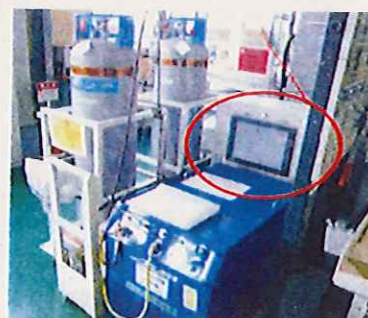
ポンベ重量監視システム
