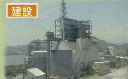
バイオマスボイラ
