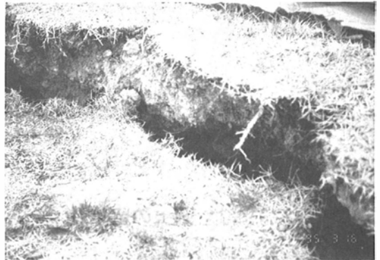
写真1 土堰堤天端の表層滑りによるクラック (幅10cm、高さ20cm程度の亀裂で、廃棄物面には及んでいない)
