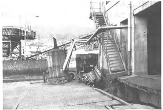
写真1 東クリーンセンター工場棟周辺部の沈下
